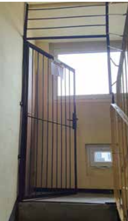
ul. Pomorska 15 Zamontowana kratka
